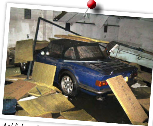
Anblick nach Abpumpen der Überschwemmung in der Tiefgarage Allensteiner Straße 118/120
