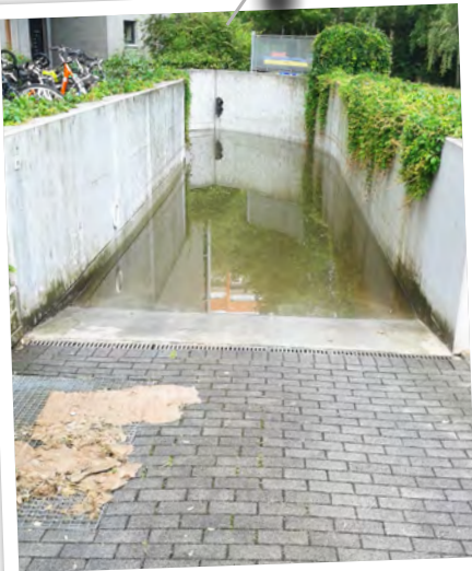
Zufahrt zur komplett vollgelaufenen Tiefgarage der Häuser Allensteiner Str. 118/120
