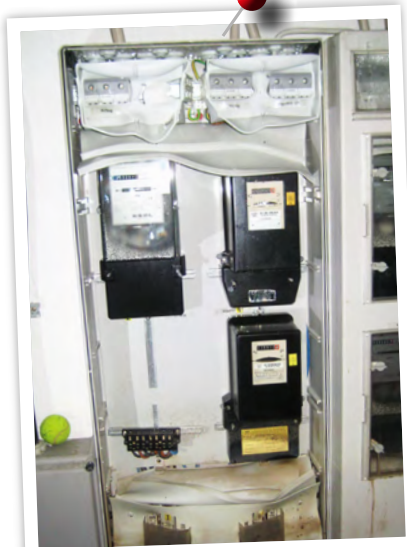
Durch kochend heißes Wasser verschmorter Sicherungskasten
